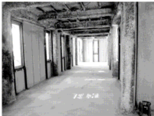
3号館（新棟）と2号館（北棟）とをつなく渡り廊下です。これから内装工事に入っていきます。
